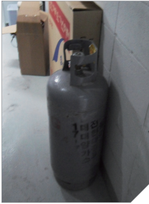
가스 저장용기 설치장소에 아무렇게나 방치
